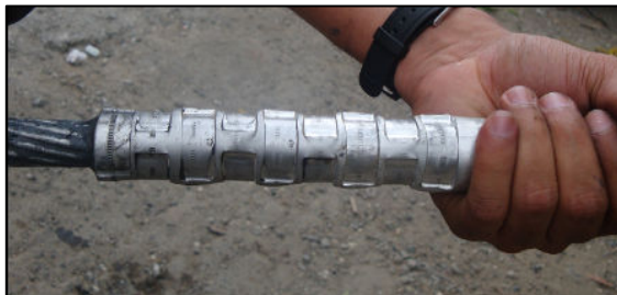
Figura N°6. Conector Comprimido de un lado.
