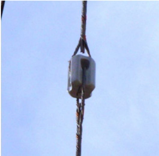
Figura N°4. Aislador tipo tensor
