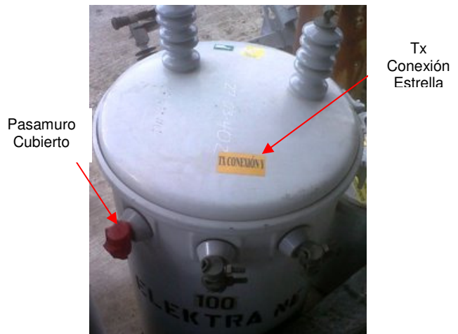
Figura N° 16. Transformador 208Y/120 V.
