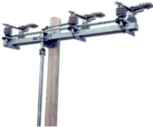
Figura N° 14. Interruptor aéreo configuración horizontal.
