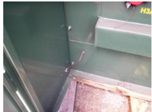
Figura N° 10. Conductor de conexión a tierra de transformadores tipo gabinete en la sección de alta.
