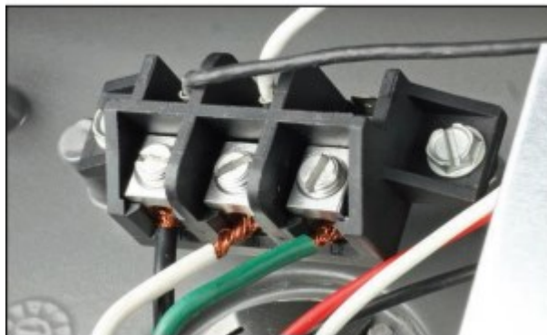
Ejemplo de bornera que cumple con requisitos de ENSA.
