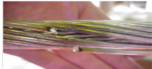
Figura N° 10. Superficie de conductor fracturado por descarga. Las grietas en los conductores causan pequeños arcos entre las partes separadas causando fatiga, corrosión y descarga eléctrica hasta que las hebras rompen.
